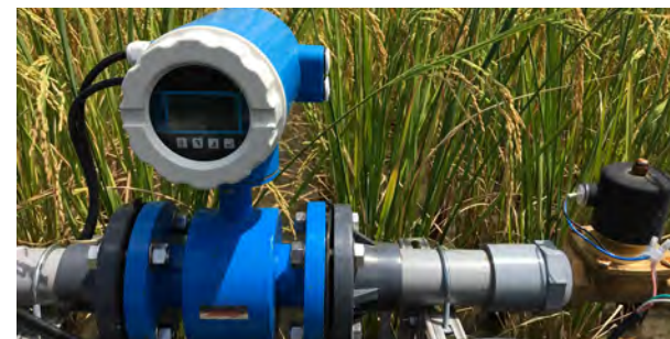
▲遠端控制水閘
