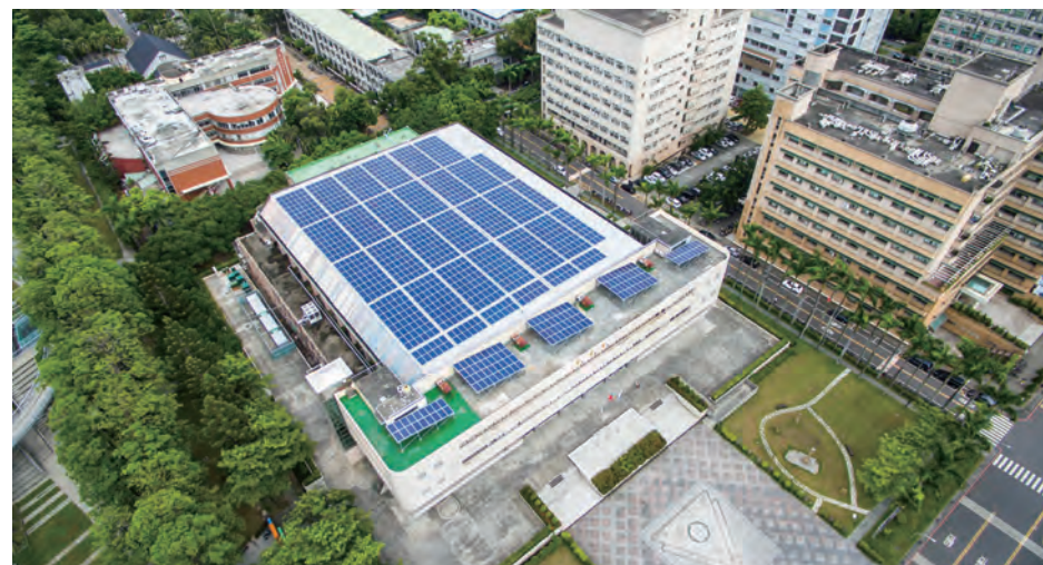
▲ 惠蓀堂屋頂太陽能光電發電設備
